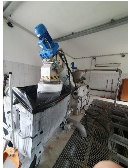
Abbildung 26: Sandwaschanlage mit nachgeschalteter Rechenanlage
